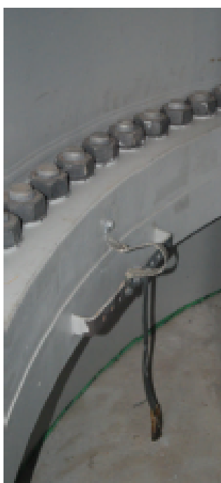
Fig. 7 : Raccordement de la barre de compensation de potentiel avec le système de mise à la terre de l'éolienne
