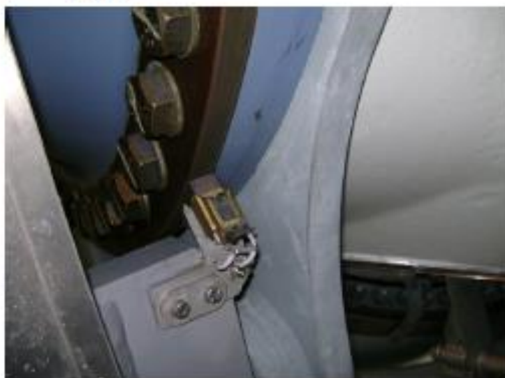
Fig. 3 : Balais de charbon avec éclateurs parallèles sur le disque d'arrêt du rotor
